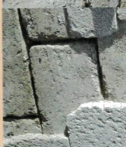
Joints en creux, qui à terme, abîment la pierre et le mur.
