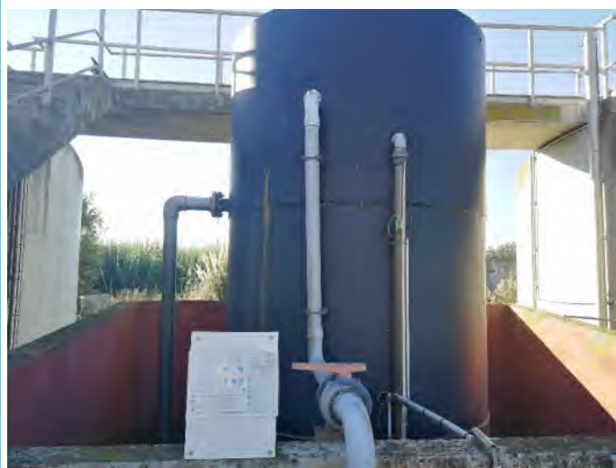
Cuve de chlorure ferrique
